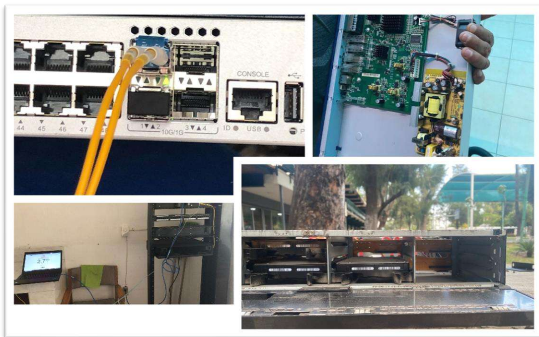
Ilustración 59. Mantenimiento a Racks.
